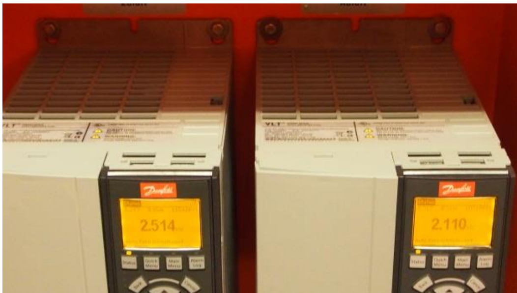
Figur 10. Effektförbrukning TL- och FL-fläktar by-pass över VVX.
